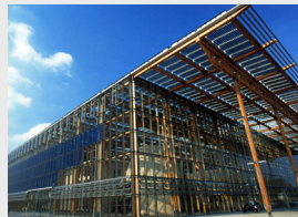
10.000 m 2 ... de cellules photovoltaïques en toiture et en façade !
