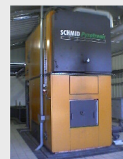
Chaudière au bois entièrement automatisée
